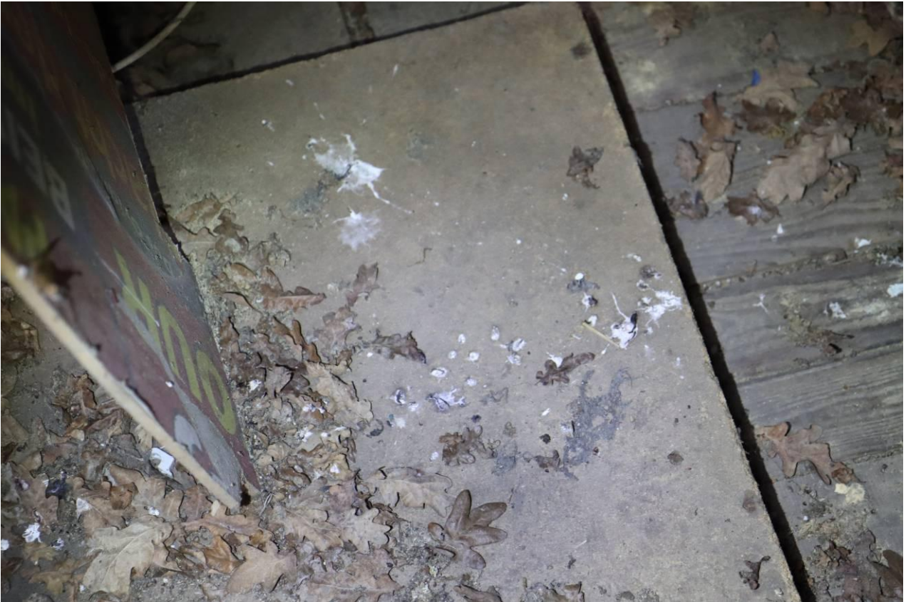
Abbildung 17: Frische Kotspuren von Kleinvögeln im Dachgeschoss des Stall- und Lagergebäudes.
