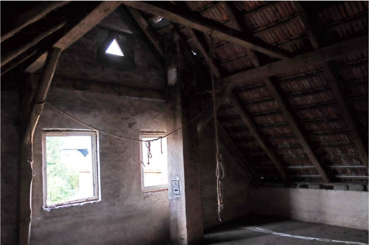
Abbildung 7: Dachstuhl oberhalb des Wohntraktes – Blick nach Osten. Die bestehenden Fenster wurden durch Vandalismus zerstört.
