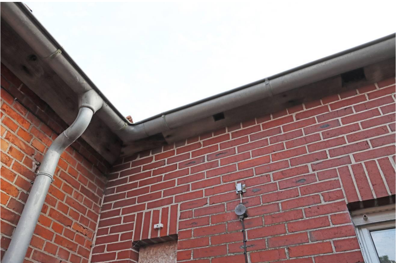
Abbildung 4: Öffnungen und Spalten im Traufbereich des Hauptgebäudes.
